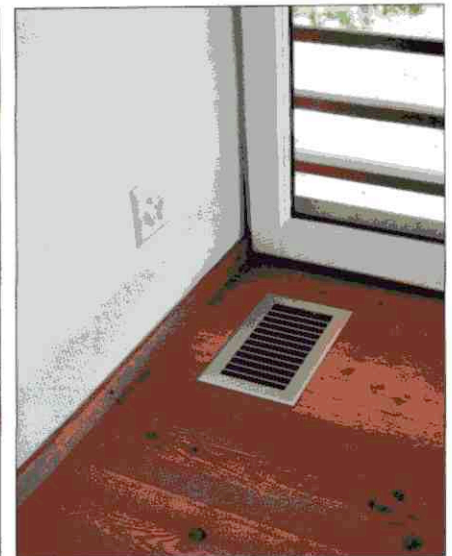
Détail diffusion de chaleur dans chambre d'enfant à l'étage supérieur.
