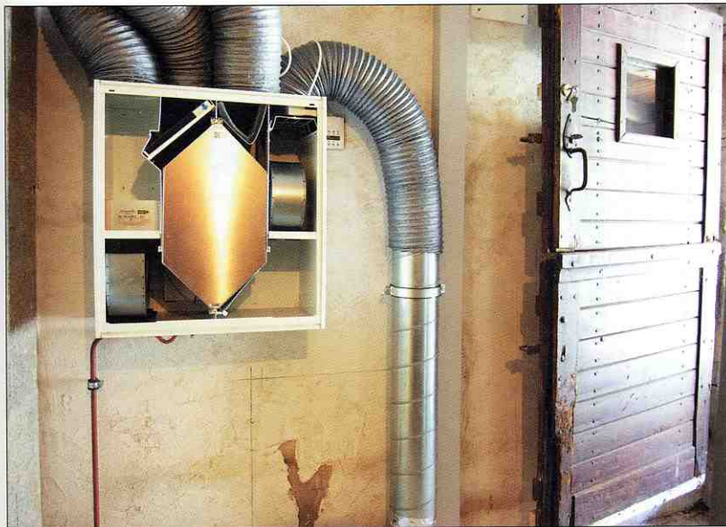
Une ventilation contrôlée double flux garantit aux occupants un apport constant d'air frais et sain dans chaque pièce, tout en retirant l'excès d'humidité, avec sa porte d'entrée de l'étable d'origine.
