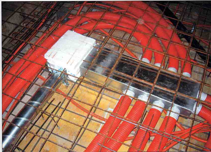
Boîte de distribution pour la ventilation située dans la dalle.
